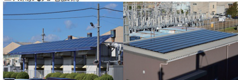
■太陽光発電設備
