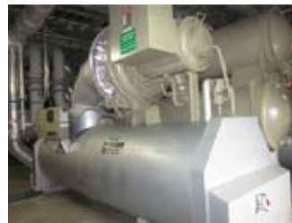
ターボ冷凍機排熱利用による省エネ
