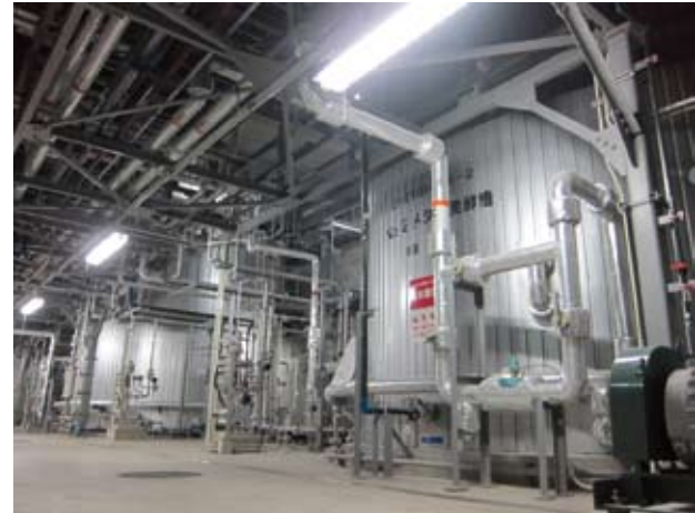
バイオガス設備 (あべのハルカス)
