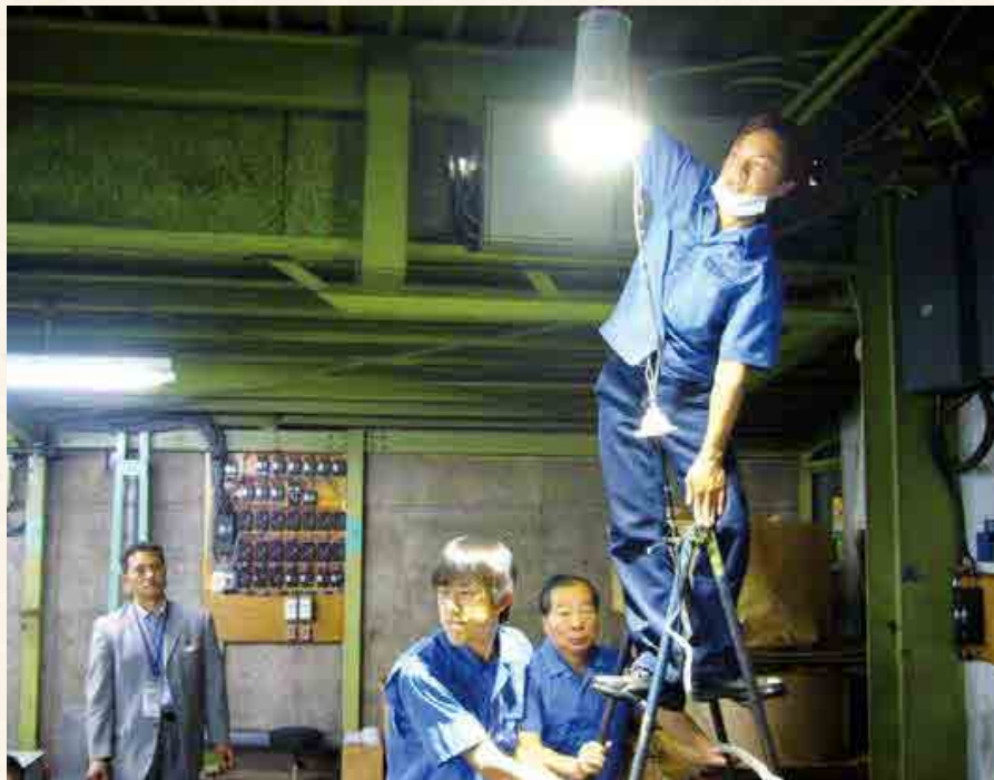
▲ 工場内の照明をLED化(2011年)
