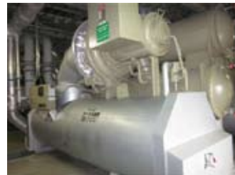
ターボ冷凍機排熱利用による省エネ
